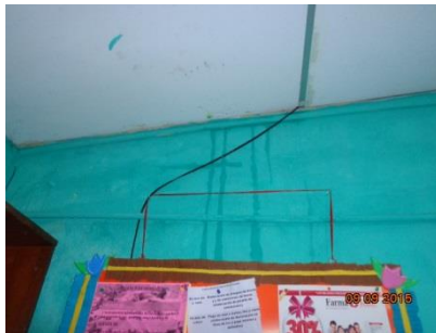
Wasserspuren an den Bürowänden
